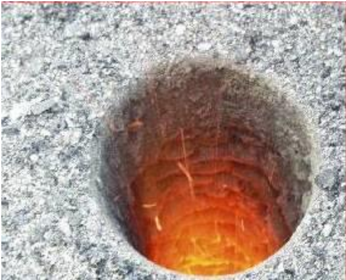
Bild 6: Brennende Rußschicht im Mündungsbereich des Kamins ohne Flammen-ausbildung und ohne merkliche Rauchentwicklung.
