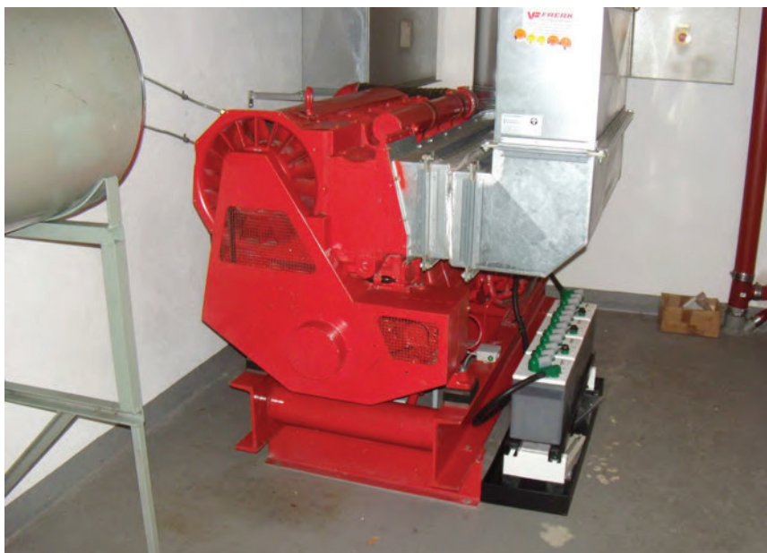
Die Netzersatzanlage (stationär) des Feuerwehrhauses in Korbach.
