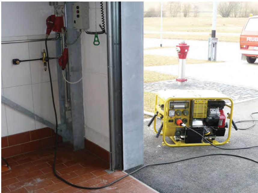
Einspeisung mit einem tragbaren Stromerzeuger über die Einspeisestelle in die elektrische Anlage des Feuerwehrhauses in Münchhausen.
